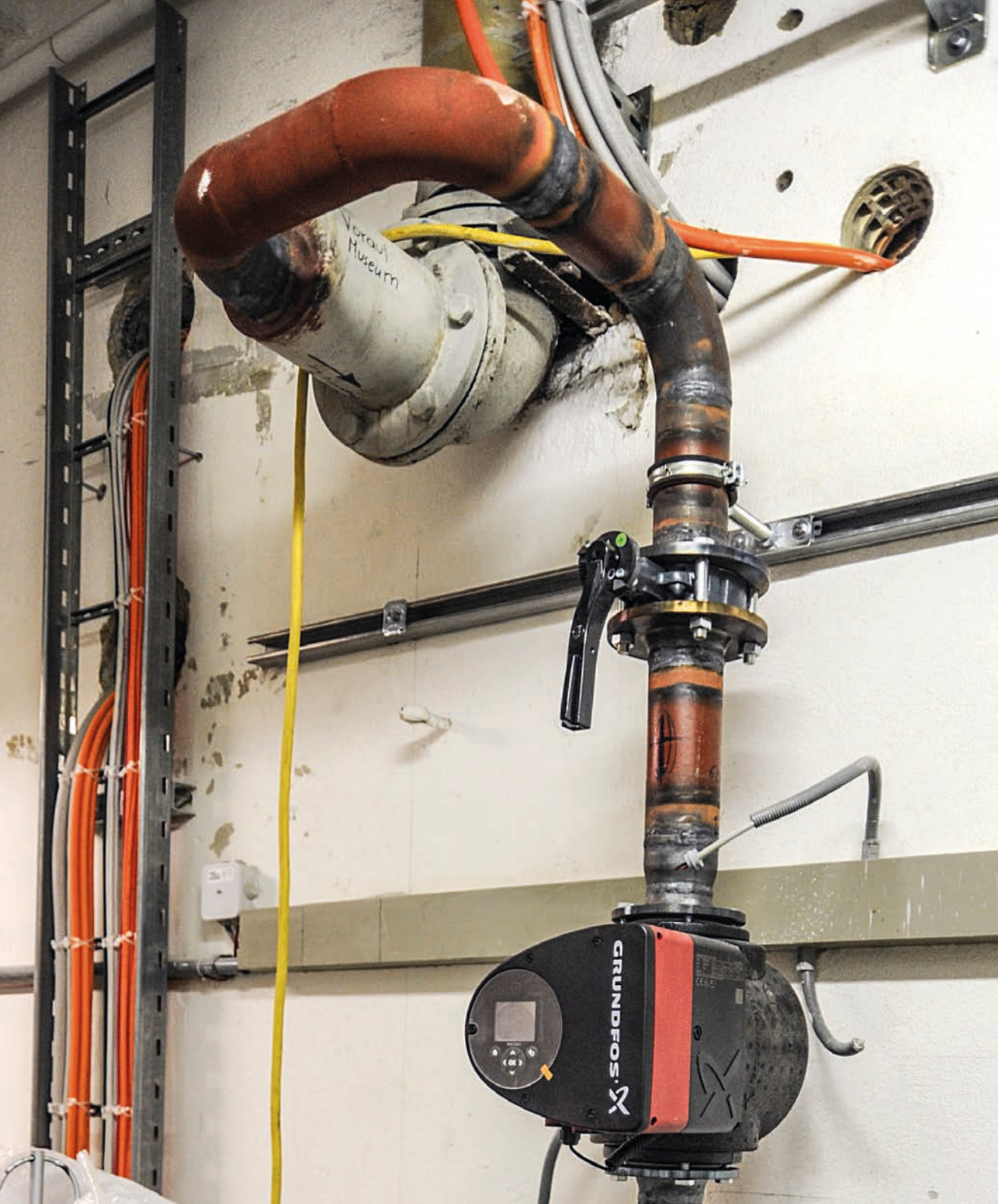
Neue Heizungsanlage. Hauptleitung mit Umwälzpumpe
